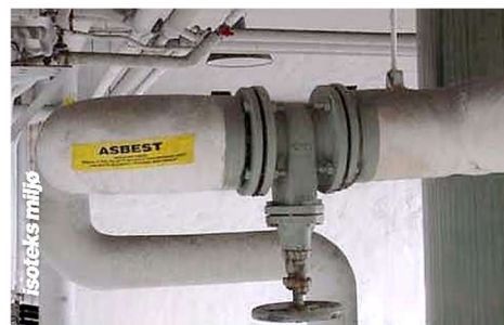
Rørisolering hvor kiselgur er blotte Foto: Lav-Det-Selv.dk
